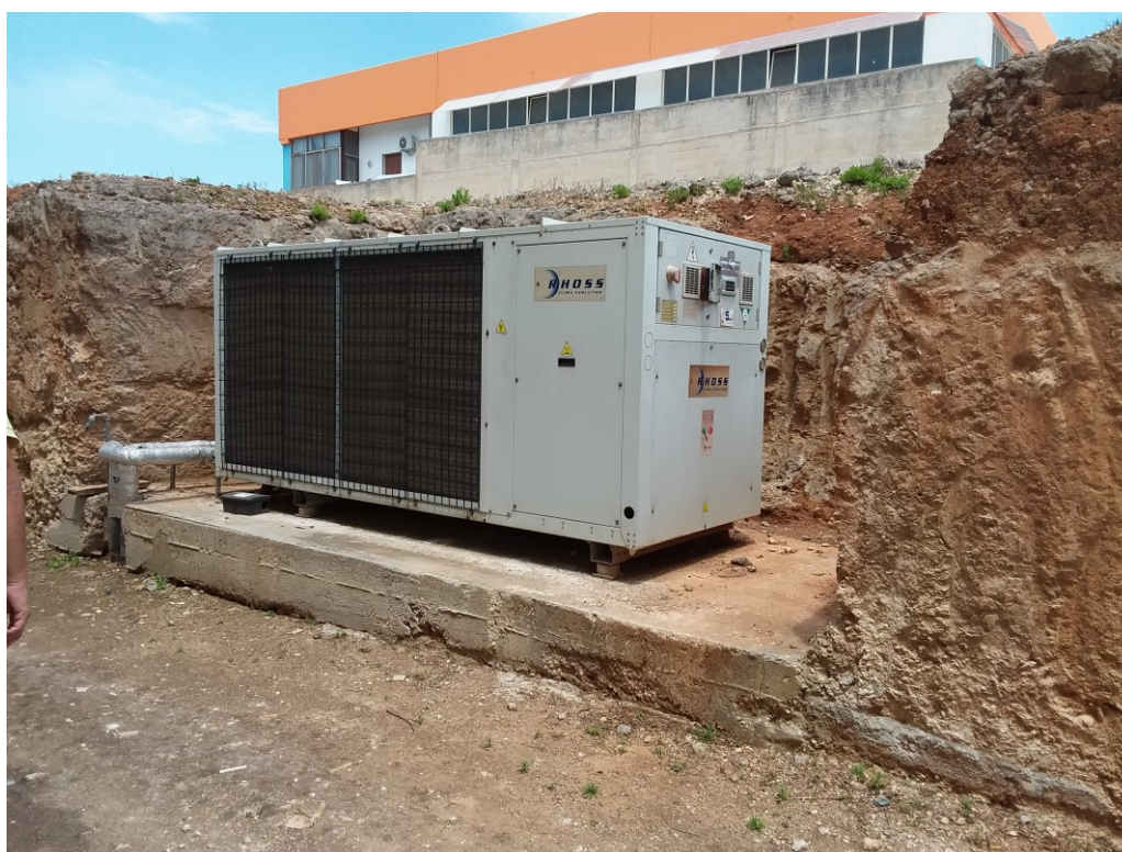
Figura 6 - Unità di climatizzazione esterna
